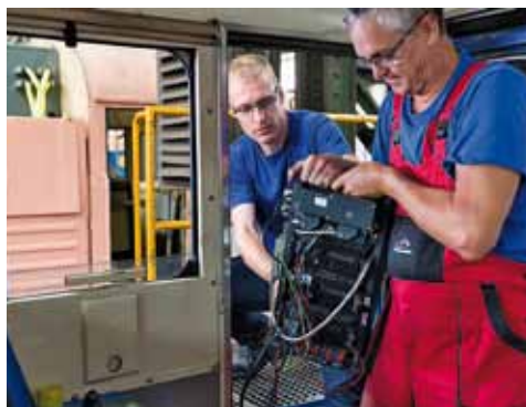
Instalace radiostanice GSM-R
