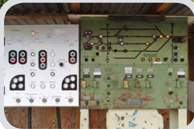
Zabezpečovací zařízení ve stanici Storuman
