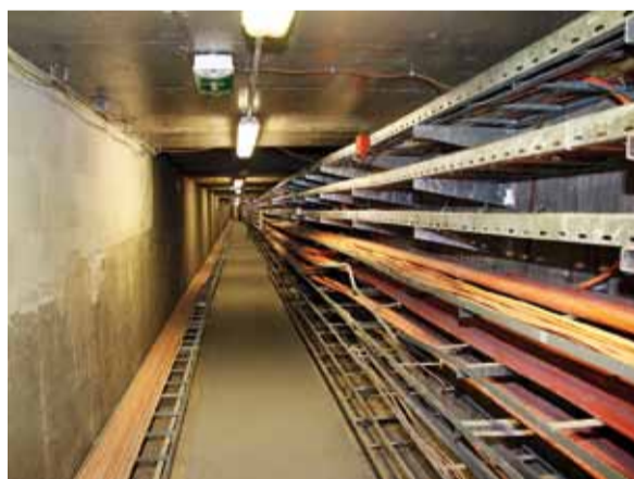
TECHNIKA. V podzemí najdeme mohutné technologické celky včetně kabelů. FOTO AUTOR (4x)
