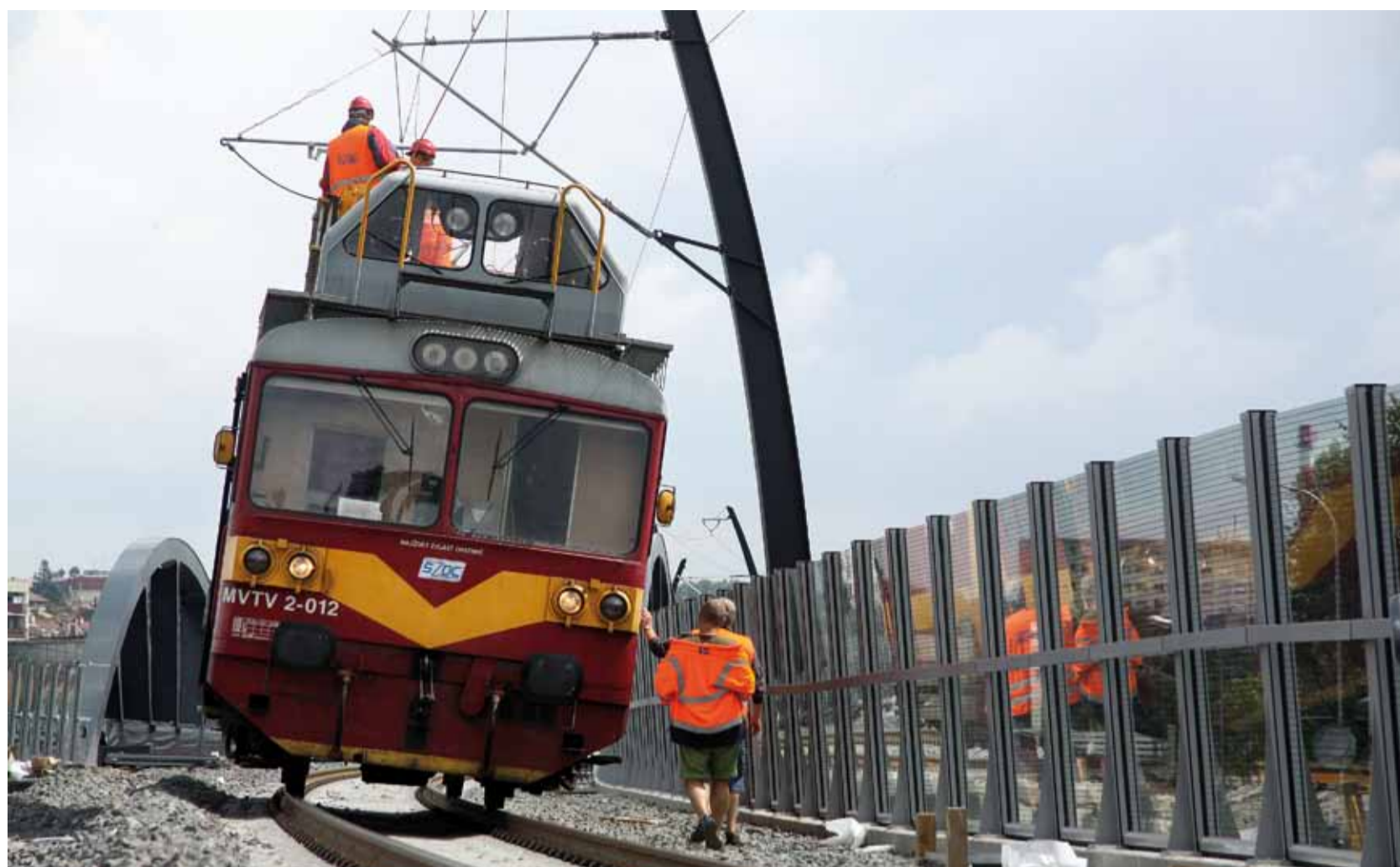
FINIŠ. Dokončovací práce na estakádě předcházely zahájení provozu po jedné koleji v neděli 17. srpna. Dvukolejně by se tu mělo jezdit od počátku září. FOTO AUTOR (2x)
