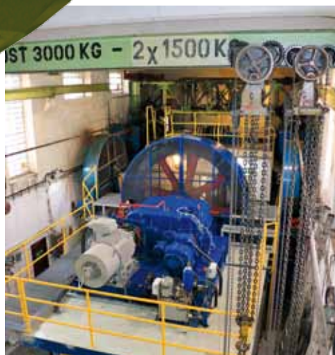
Modernizací prošla také strojovna lanovky. Novinkou je i střídavý motor se zvýšeným výkonem 250 kW.
