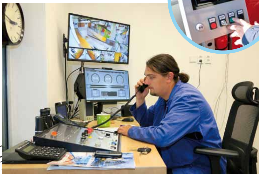
Na řídicím stanovišti na Ještědu je na displejích k dispozici přesný počet cestujících a strojník má na svém pracovišti ve vrcholové stanici k dispozici sofistikovaný monitorovací kamerový systém.
