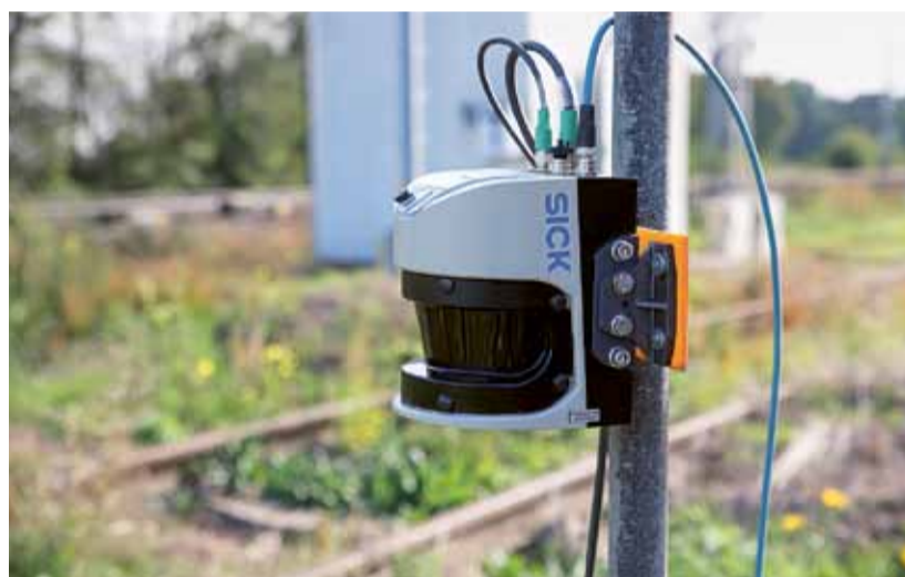
STRÁŽCE. Čidla laserového systému monitorují přesně vymezenou plochu podobně jako radar v době, kdy je přejezd ve výstraze.
